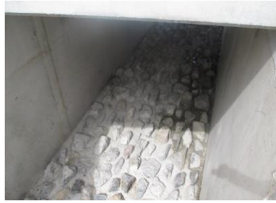
Blocs béton passe à poissons
